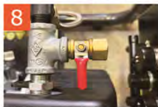
8 シリンダー後ろの排気バルブの赤いコックを閉めます
